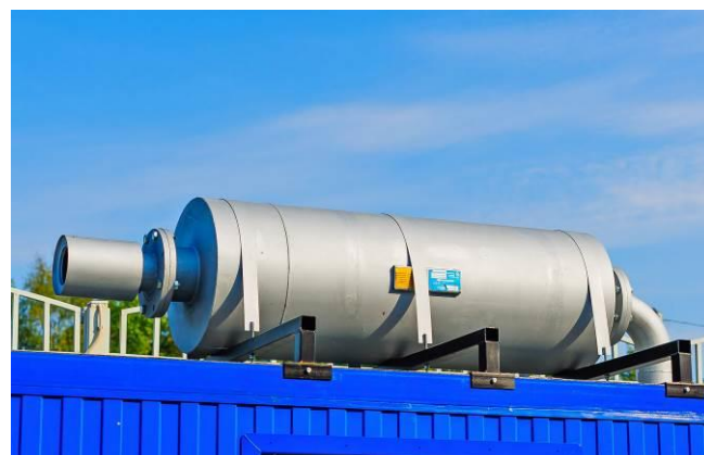
Промышленный глушитель с искрогасителем на крыше контейнера
